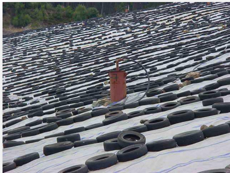
Ilustração 21 - Poço de biogás.
