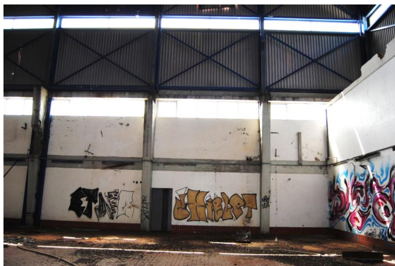
Fig. 3.14- Estrutura da zona de secagem (Leça do Balio)
