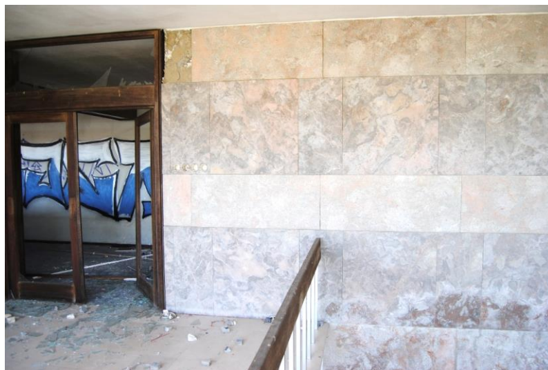
Fig. 3.32.- Revestimento zona de escadas (Leça do Balio)
