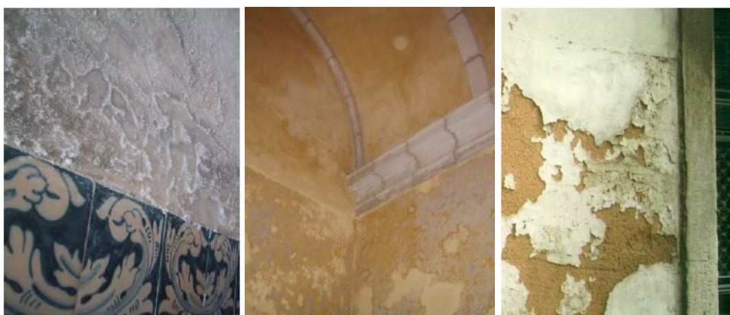
Fig. 2.17 - Exemplos de diferentes padrões de degradação por sais em edifícios [1]
