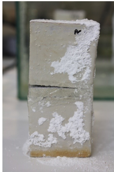
Fig. 4.21 - Descolagem da camada superior do provete PC2.1 devido à pressão criada pelos cristais de sulfato de sódio
