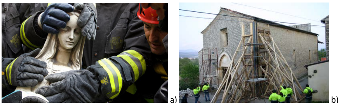
Figura 1 – a) Bombeiros resgatam uma Madonna de mármore do topo duma igreja em Paganica (sismo de L'Aquila de 06/04/2009); b) [Fonte: Max Rossi, Reuters]; b) Obras de escoramento provisório da Igreja de S. Maria Ad Cryptas (sismo de L'Aquila de 06/04/2009).
