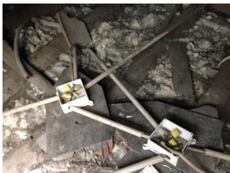
Figura 7.5: Instalação elétrica obsoleta
