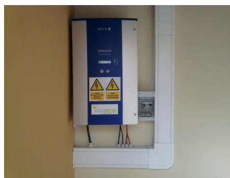
Figura 3.7: Inversor DC/AC para transformar corrente contínua em alternada
