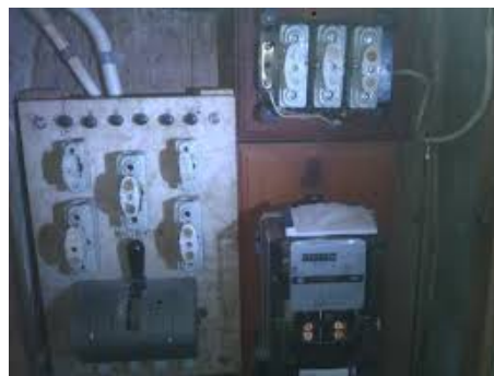
Figura 7.6: Quadro elétrico com fusíveis
