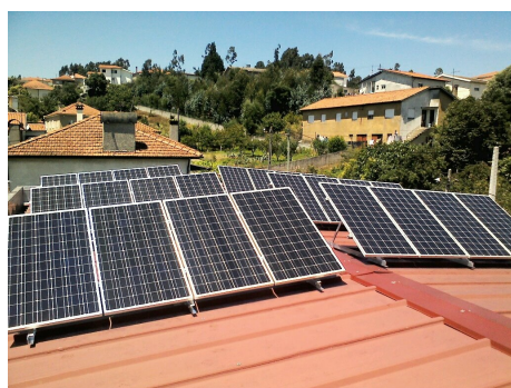
Figura 3.6: Painéis Foto Voltaicos instalados numa cobertura
