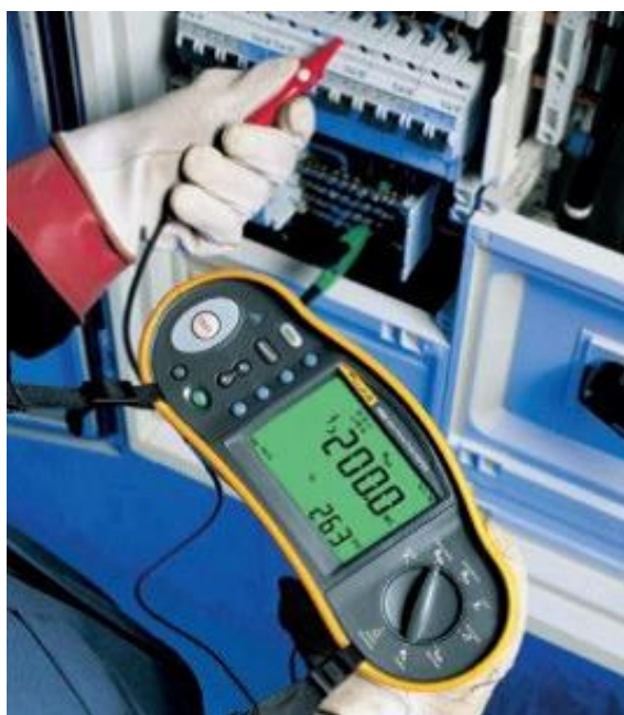
Figura 6.2: Técnico Responsável realiza uma análise de energia da elétrica
