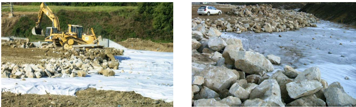
Figura 3.34 - Geotêxtil não tecido sujeito a ações mecânicas de danificação durante a instalação.
