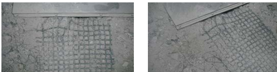
Figura 5.12 - Zona onde ocorreu rotura da GGT, intacta.
