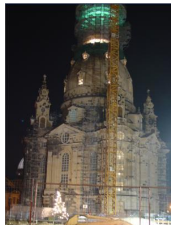
Figura 2.7 - Reconstrução integral da Church of Our Lady (Frauenkirche) após o conflito armado da 2ª Guerra Mundial (Dresden, Alemanha)
