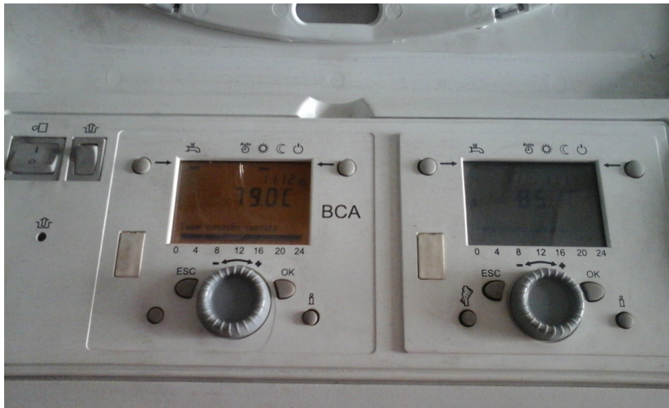
Figura 4.20: Pormenor da caldeira existente no local do estudo
