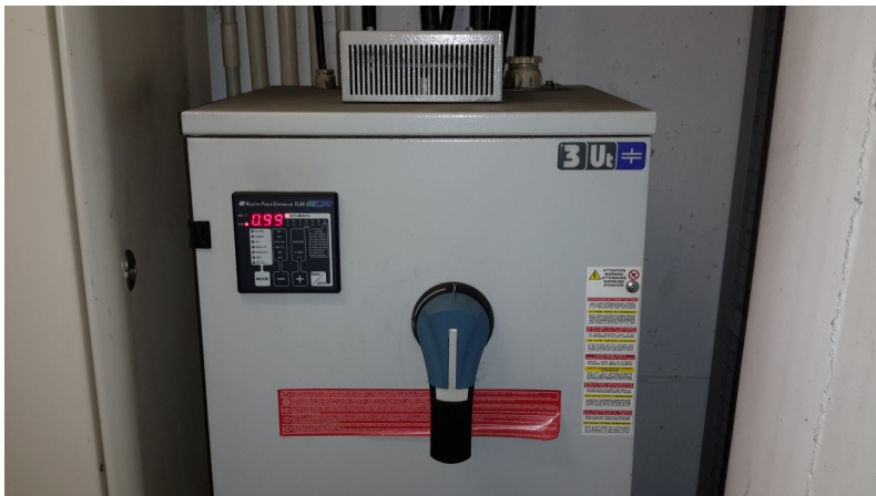
Figura 5.21: Bateria de condensadores
