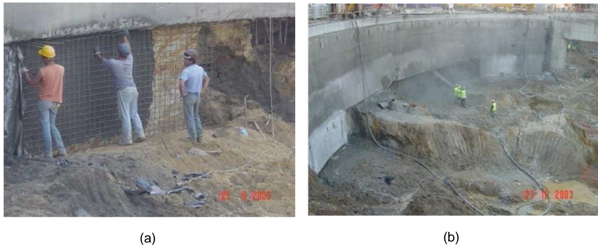
Figura 1 - a) Colocação de armaduras para posterior aplicação de betão projetado; b) projeção de betão (Topa Gomes, 2008).
