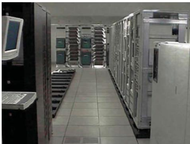
Fig.5.16. – Equipamentos de data centre colocados sob isoladores de base [21]
