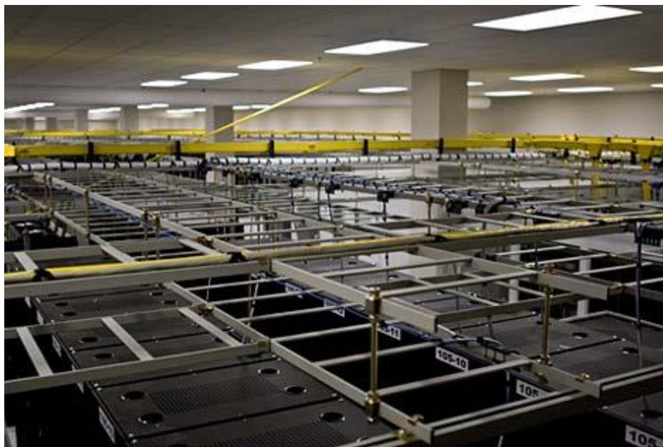
Fig.4.8. – Vista do interior do QTS Metro data centre , EUA [w18]
