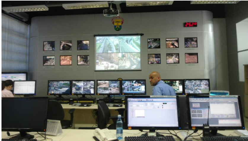
Fig.51 – Central de controlo e monitorização da EPTC, Porto Alegre (2011).
