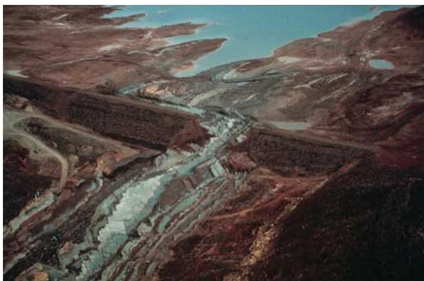
Figura 3.81 – Rutura no Dique Quail Creek (retirado de [59])
