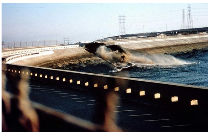
Figura 3.77 – Formação de brecha na barragem Baldwin Hills (retirado de [57])
