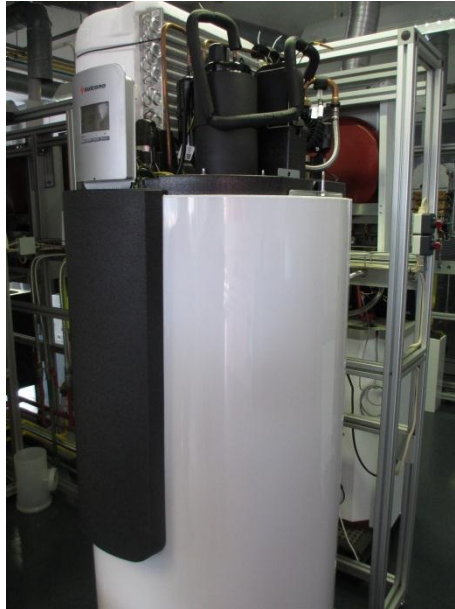
Figura 3 – Bomba de Calor para preparação de AQS.
