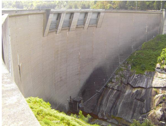
Fig. 5. 2 - Pormenor dos descarregadores atualmente instalados [36]
