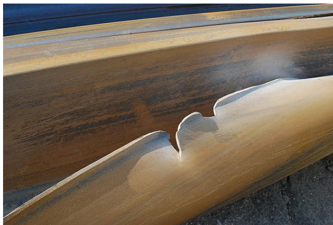
Fig. 2. 6 - Exemplo de danos causados numa estaca prancha metálica [15]
