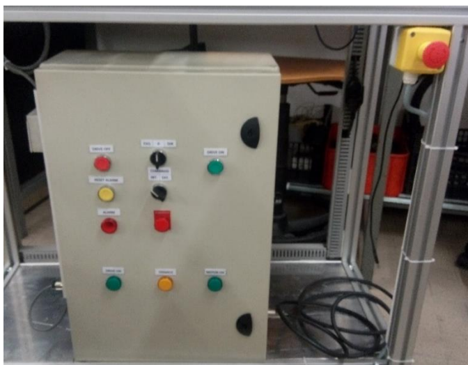
Figura 4.15 – Imagem da porta do quadro elétrico onde se localizam as botoneiras, interruptores rotativos e sinalizadores, juntamente com a botoneira de emergência.
