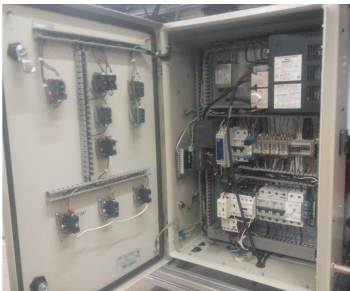
Figura 4.16 – Imagem do interior do quadro elétrico.
