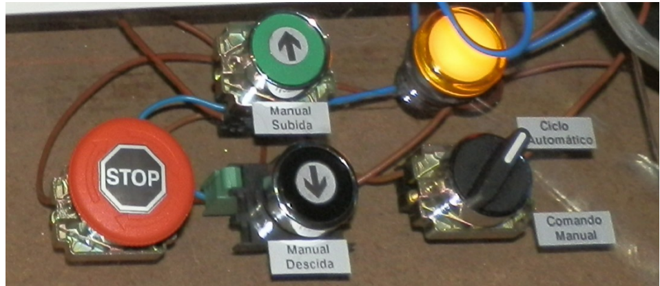
Figura 33 – Botoneiras de comando, montagem em placa de acrílico
