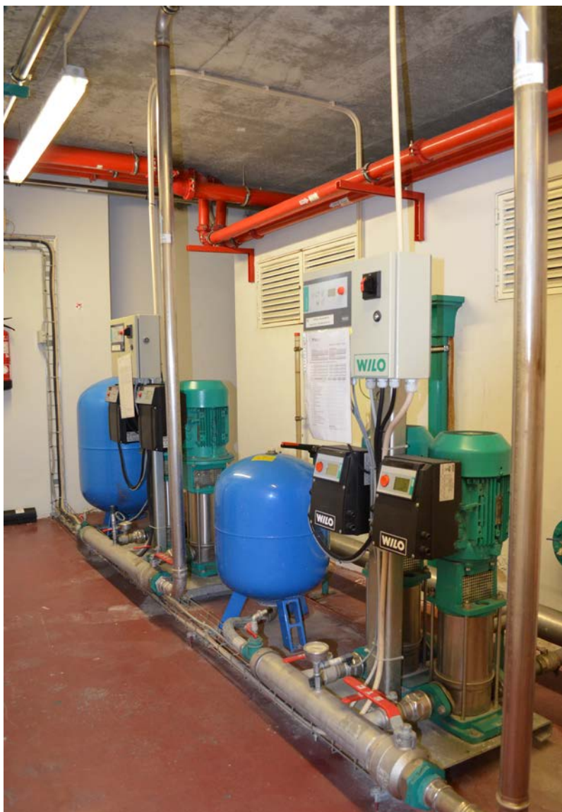
Fig. 4.40 – Sala de bombagem.
