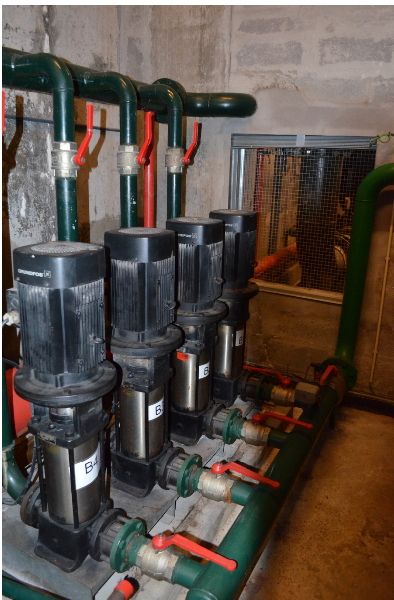
Fig. 4.34 – Sala de bombagem de água.
