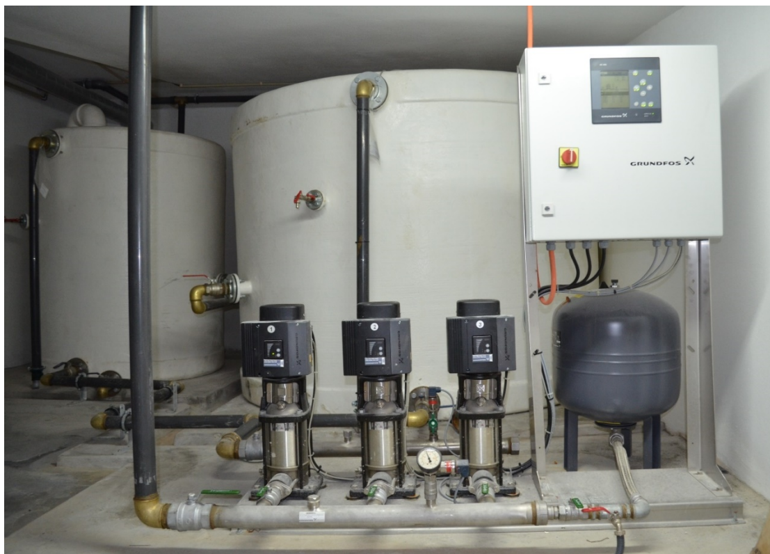
Fig. 4.46 – Sala de bombagem.
