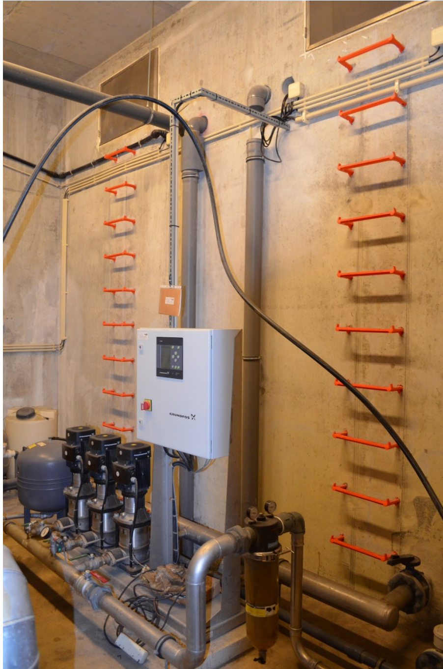
Fig. 4.55 – Sala de bombagem.
