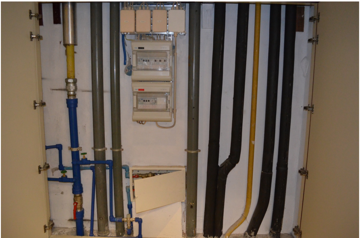
Fig. 4.8 – Armário para instalações.
