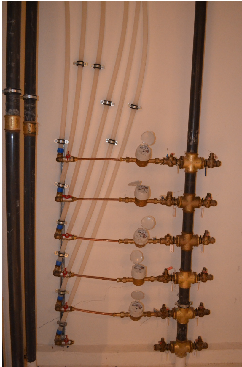
Fig. 4.49 – Armário de contadores das frações.
