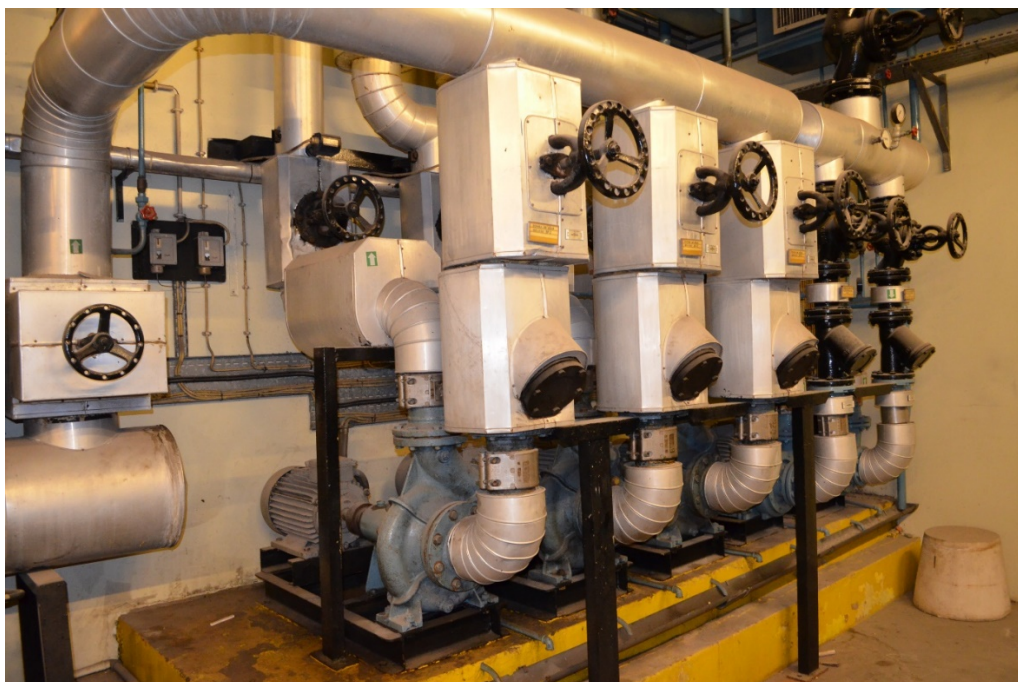
Fig. 4.1 – Central de bombagem.
