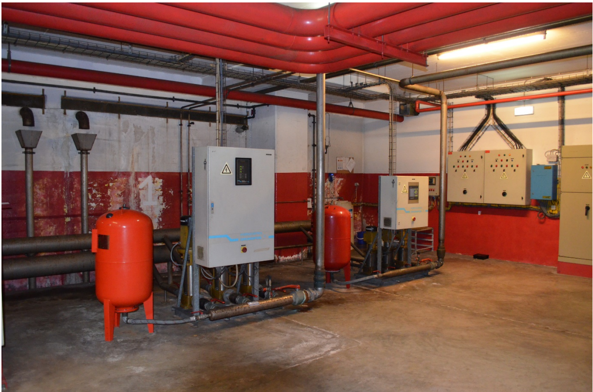
Fig. 4.28 – Central de bombagem – Grupos Hidropneumáticos.
