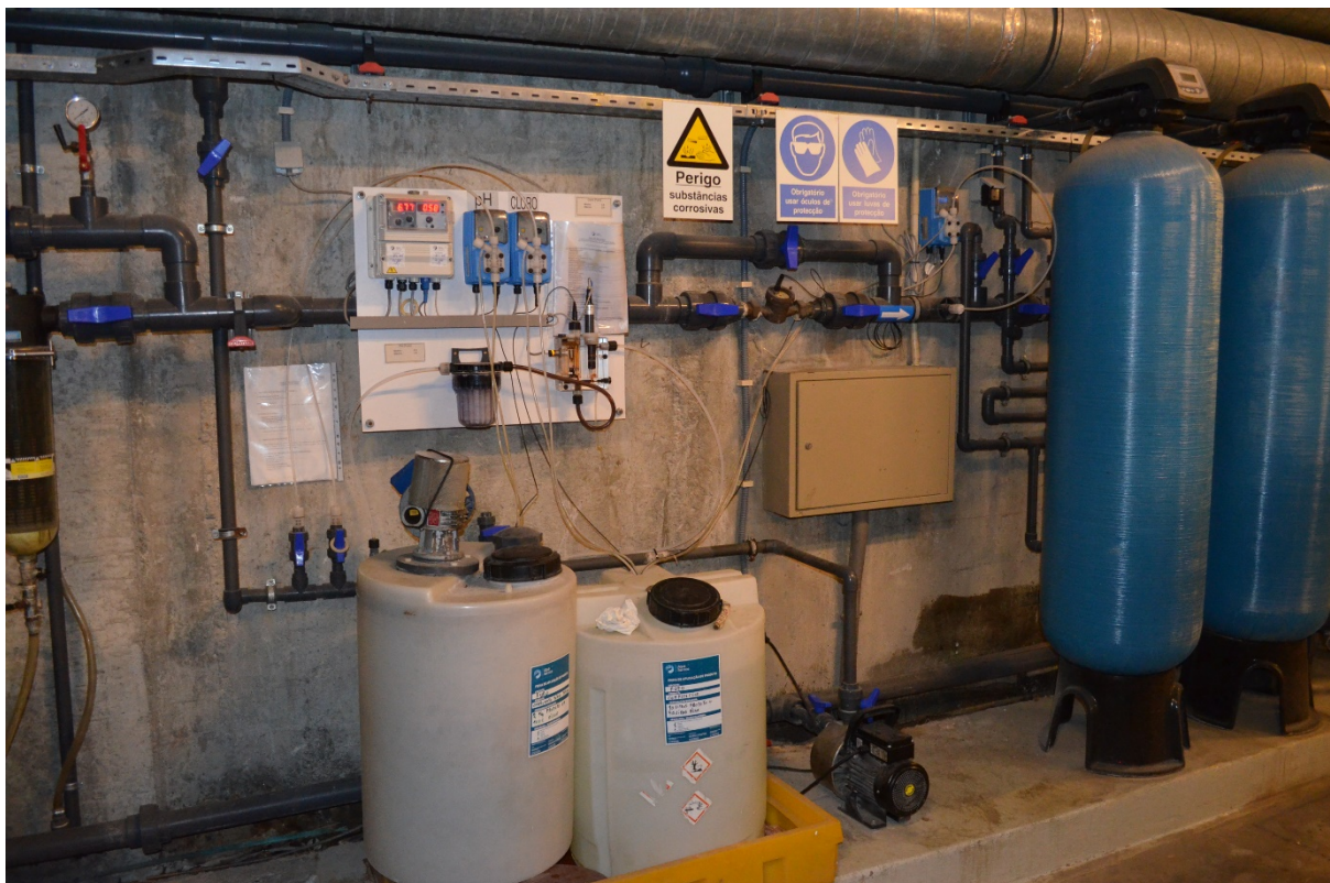
Fig. 4.37 – Estação de tratamento de água.
