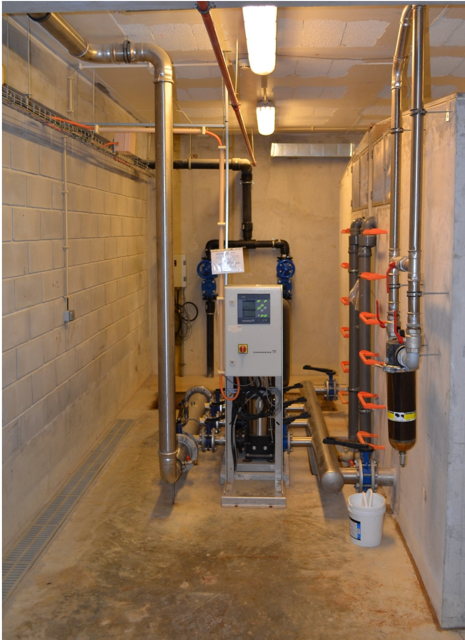
Fig. 4.58 – Segunda sala de bombagem.
