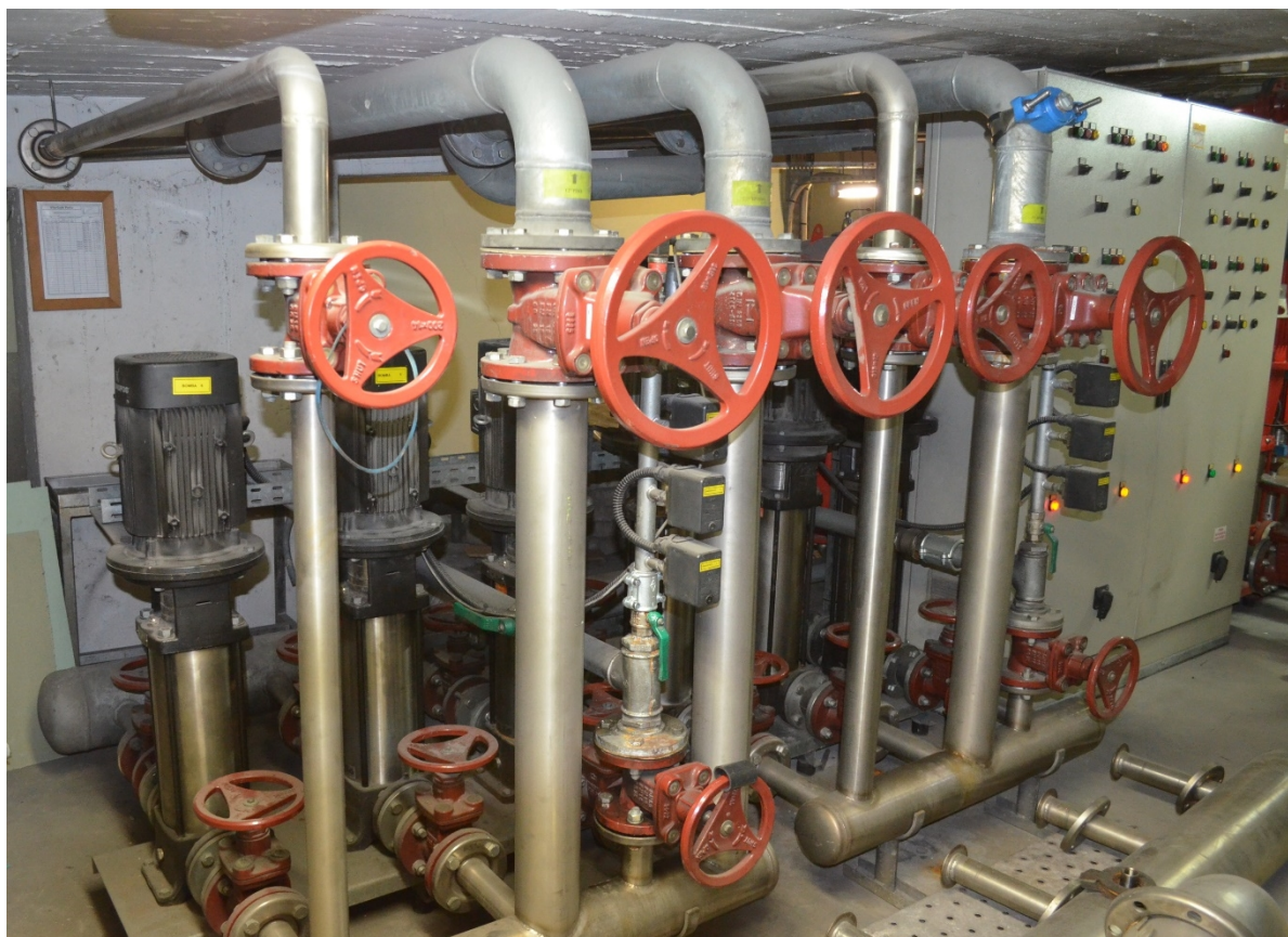
Fig. 4.22 – Sala de bombagem.
