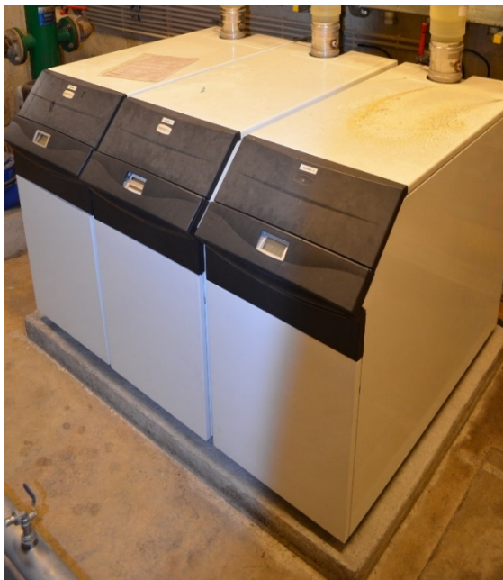
Fig. 4.56 – Caldeiras das zonas comuns.
