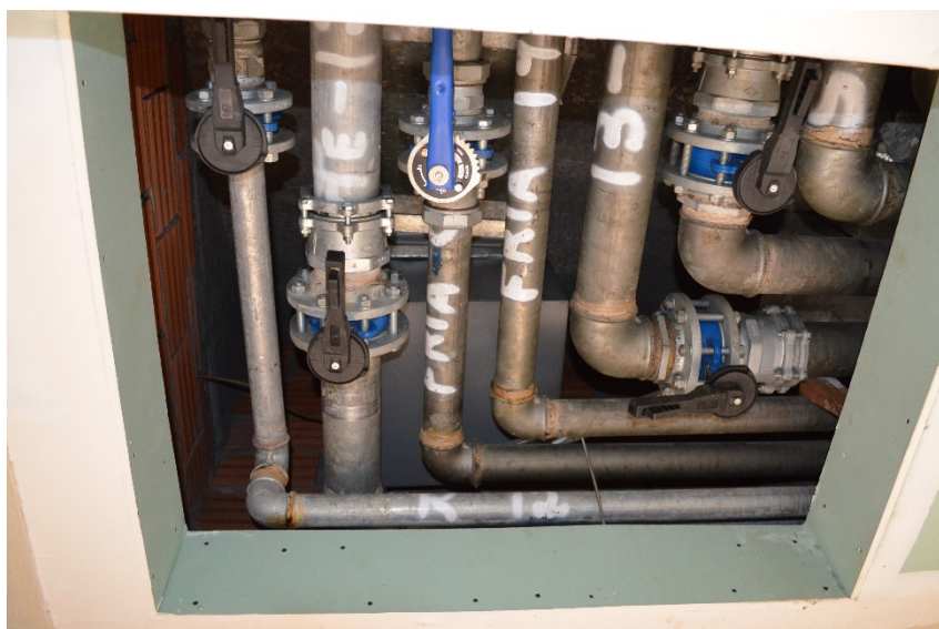
Fig. 4.18 – Entrada das colunas de abastecimento de água fria para os pisos superiores.
