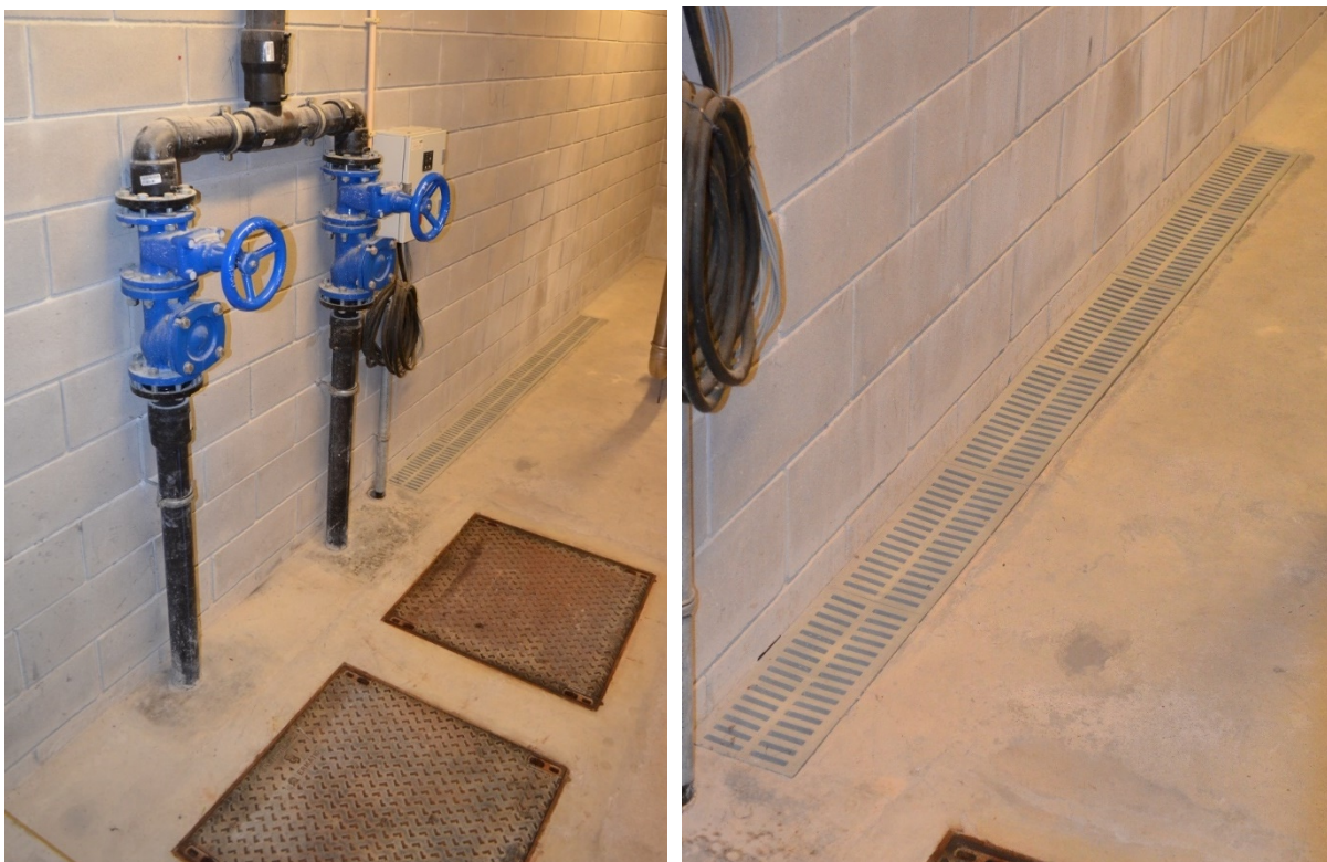
Fig. 4.57 – Câmaras de bombagem de água residuais, à direita, e ralo de drenagem, à esquerda.
