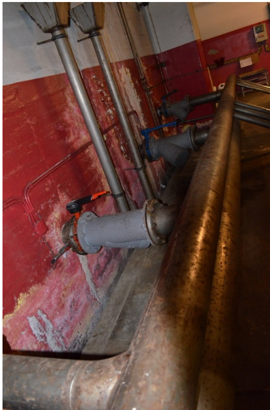
Fig. 4.30 – Central de bombagem – Drenagem.
