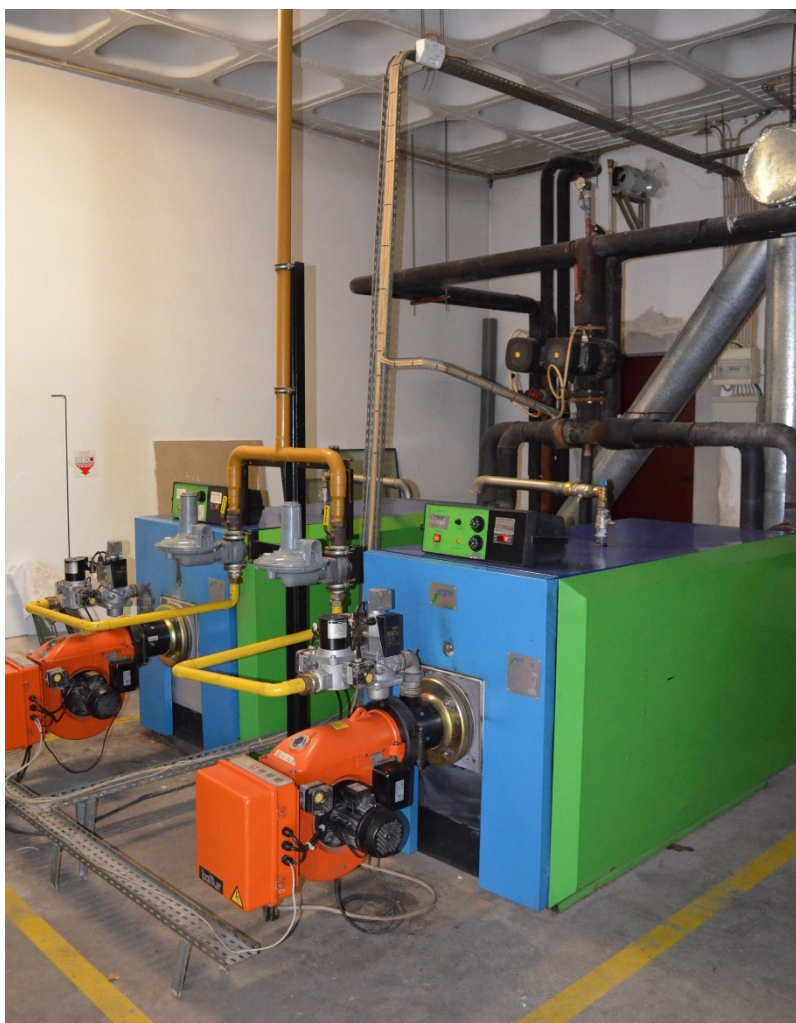
Fig. 4.19 – Sala das caldeiras.
