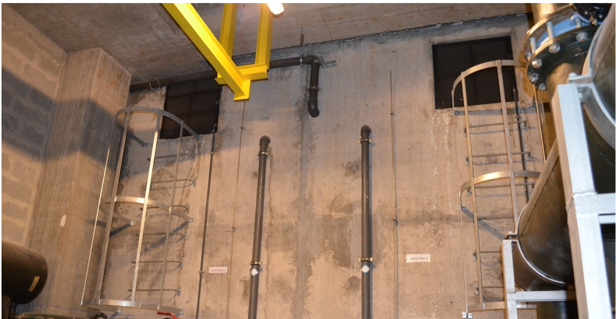
Fig. 4.36 – Cisternas de água.
