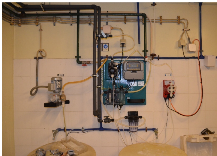
Fig. 4.7 – Estação de tratamento de água.
