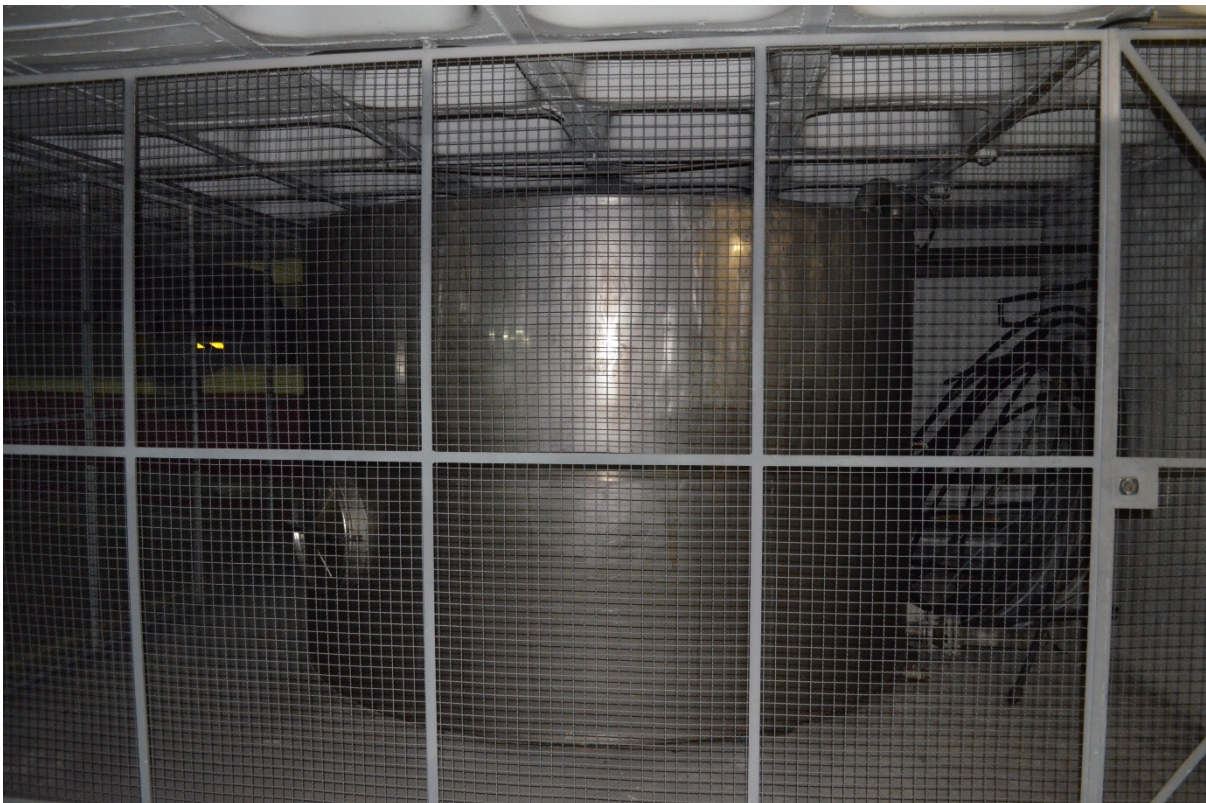
Fig. 4.20 – Reservatório de água fria.
