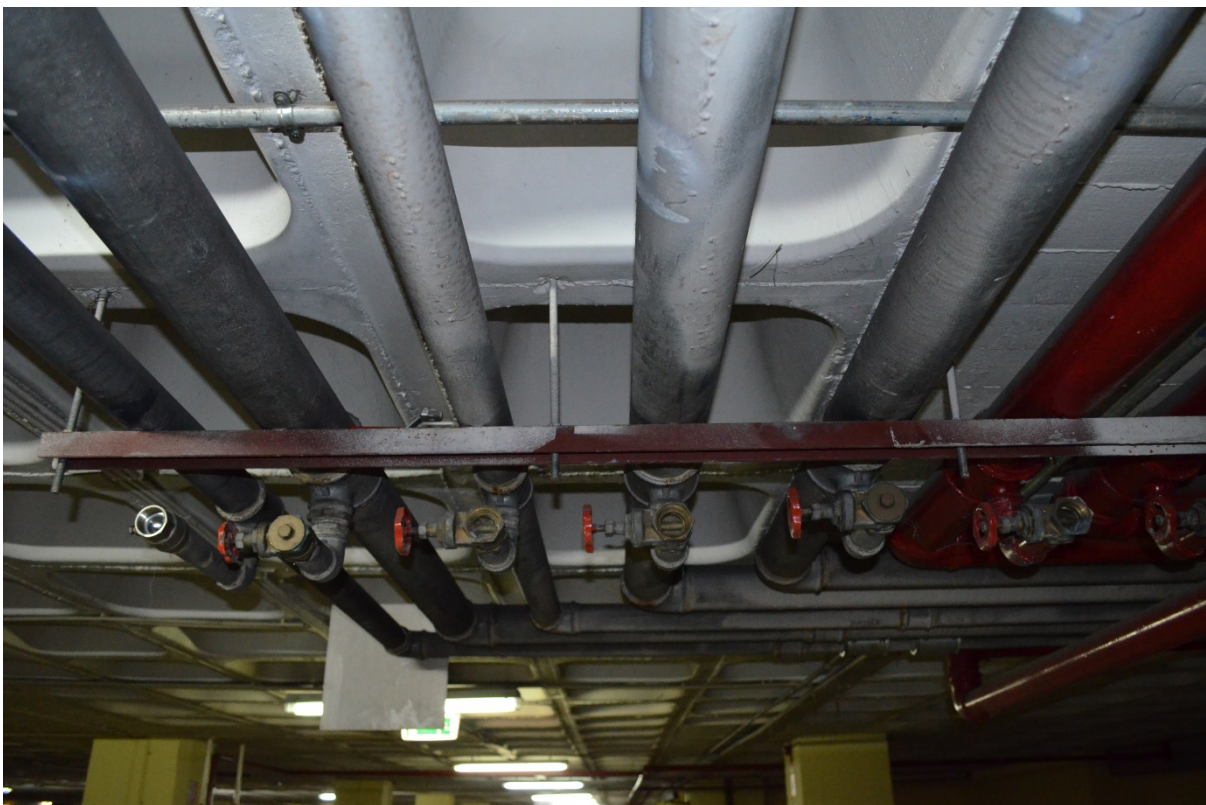
Fig. 4.21 – Pormenor de bocas de limpeza e perfil de fixação das respetivas tubagens.
