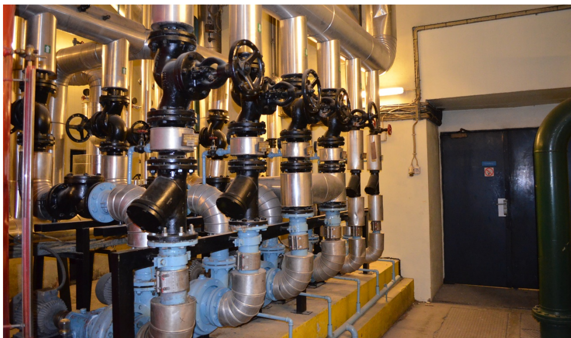
Fig. 4.5 – Conjunto de bombas para abastecimento de água quente.
