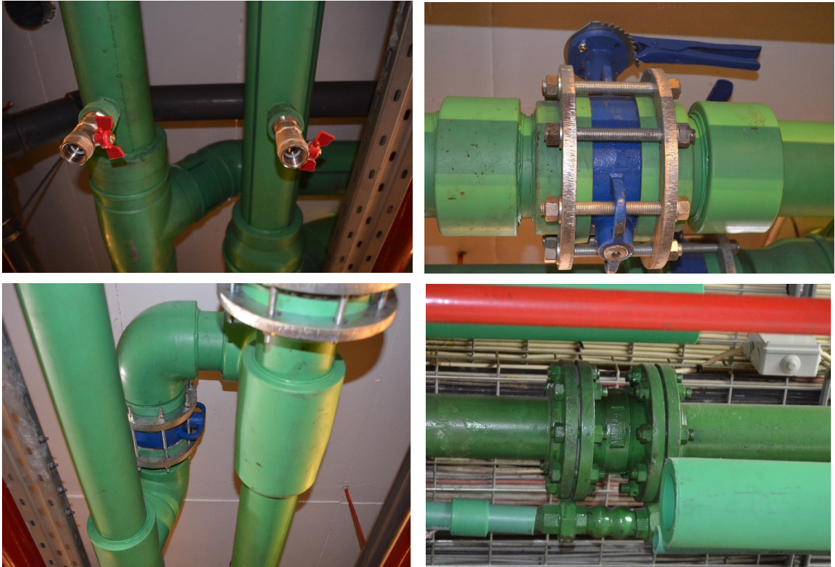
Fig. 4.26 – Bocas de limpeza e válvula de corte, em cima. Bypass e junta antivibrática, em baixo.
