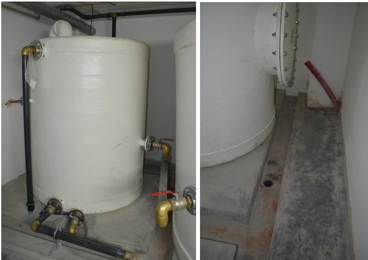
Fig. 4.47 – Reservatórios e drenagem da sala.
