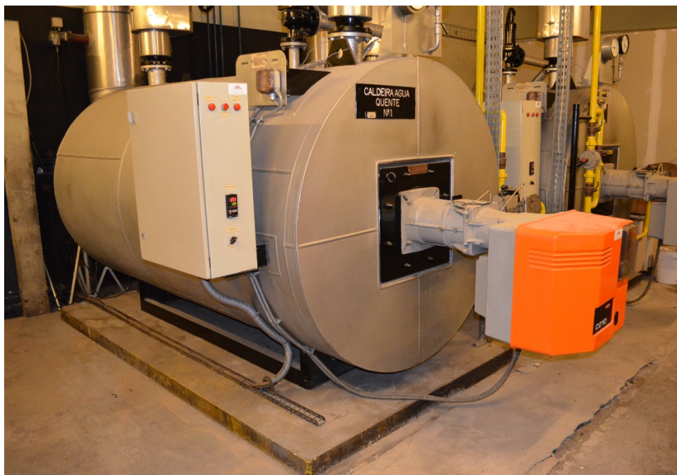
Fig. 4.2 – Sala das caldeiras.
