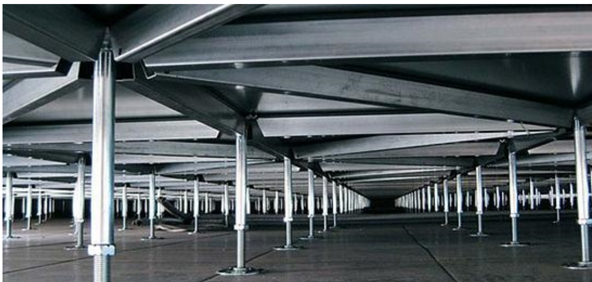
Fig. 3.8 – Interior do pavimento técnico – plenum . [37]
