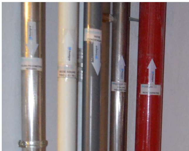
Fig. 4.44 – Rotulagem das tubagens.
