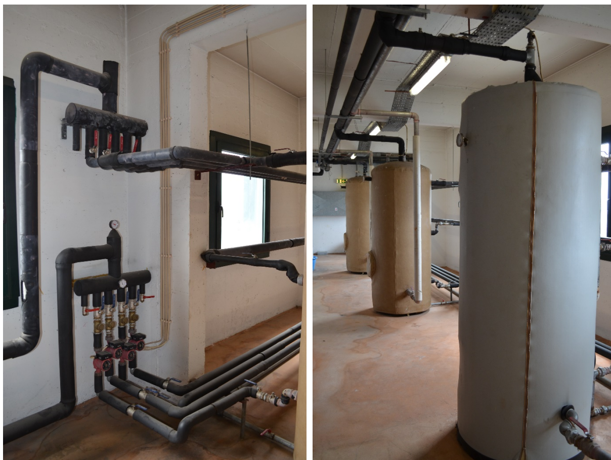
Fig. 4.16 – Área técnica para abastecimento e reserva de água quente.
