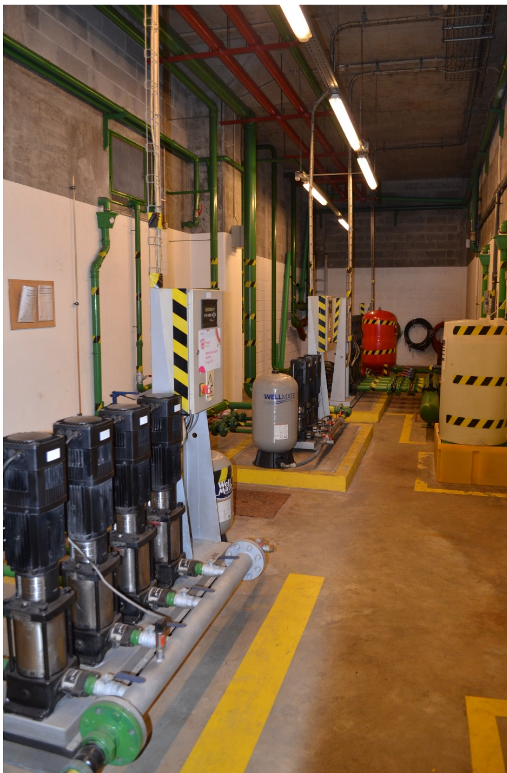
Fig. 4.27 – Central de bombagem.
