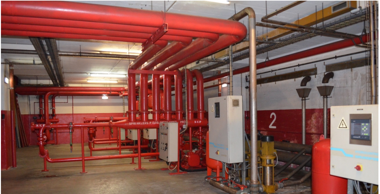
Fig. 4.29 – Central de bombagem – Serviço de Incêndio.
