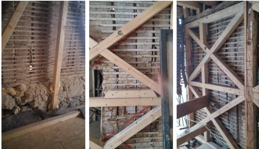
Fig.2.3 – Paredes de tabique simples (reforçadas) na rua dos Caldeireiros
