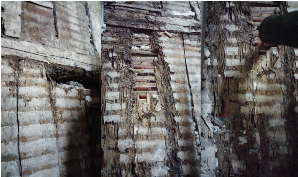
Fig.2.5 – Paredes de tabique simples degradadas do edifício da rua da Torrinha
