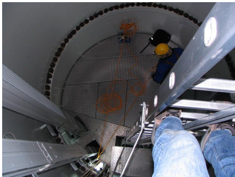
Fig.4.5 – Interior da torre eólica onde foi realizado o ensaio, e onde é possível observar uma das plataformas e a flange média aparafusada
