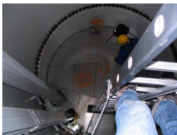
Fig.5.7 – Instalação dos sismógrafos na torre
