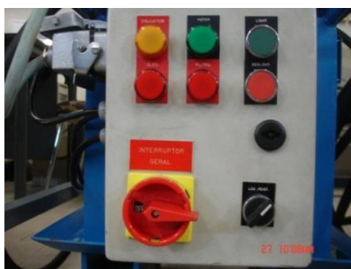
Figura 2.4 – Quadro elétrico de potência
