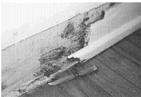
Figura 78 – Aspecto de degradação por fungos de podridão de um rodapé
