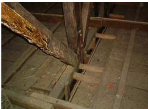
Figura 60 – Degradação de escora da asna principal (Rodrigues, R., 2004)
