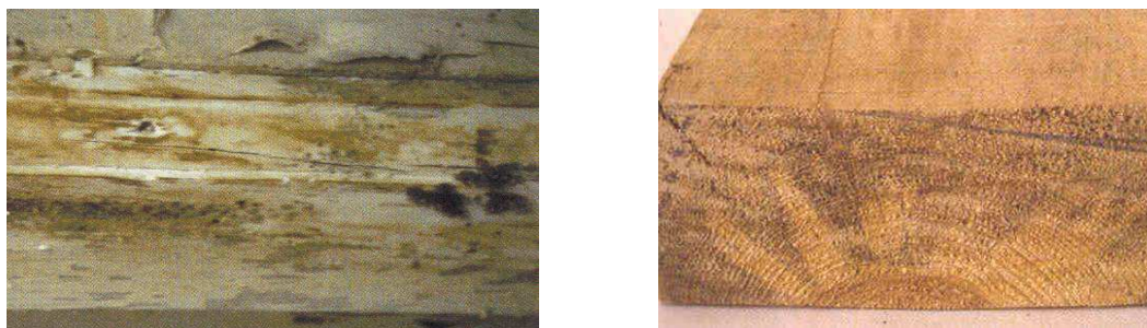
Figuras 80 e 81 – À esquerda, degradação provocada por bolores. À direita, degradação provocada por fungos cromogéneos [Arriaga, 2002]
