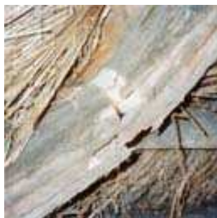
Figura 93 – Rotura de peça de madeira
