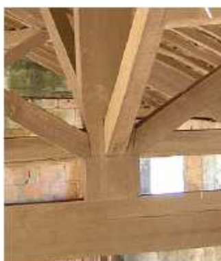
Figura 71 – Exemplo de uma ligação mal concebida entre o pendural e a linha (Branco, J., 2006)
