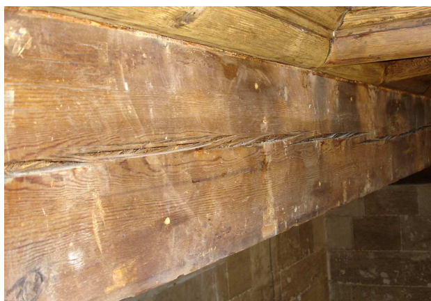
Figura 76 – Exemplo de uma fenda longitudinal (Rodrigues, R., 2004)
