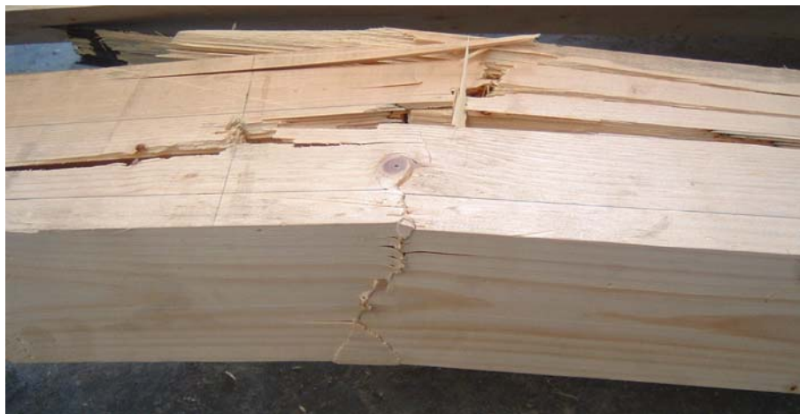
Figura 4. 50 – Compressão das fibras, na face superior da viga V03, depois de ensaiada.
