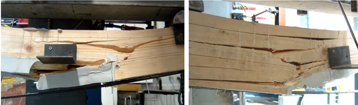
Figura 4. 59 – Rotura da viga V07.
