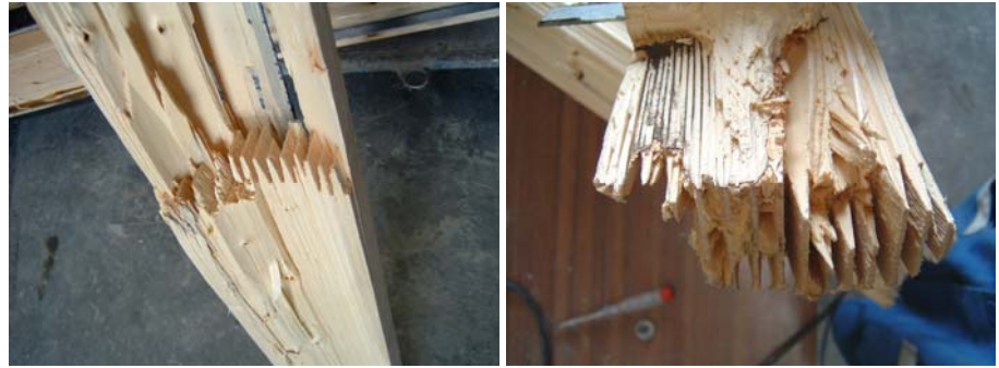
Figura 4. 57 – Rotura da viga V01, numa ligação finger joint.
