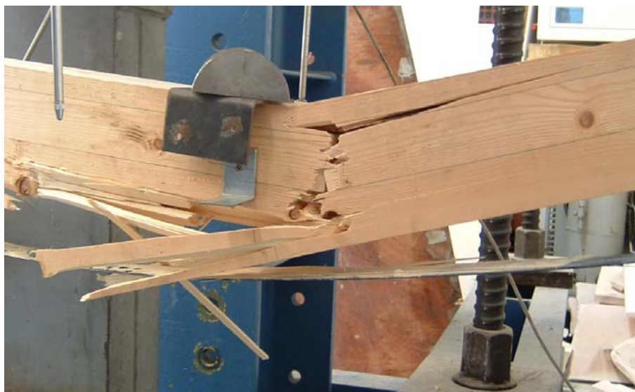
Figura 4. 51 – Rotura da viga V06.
