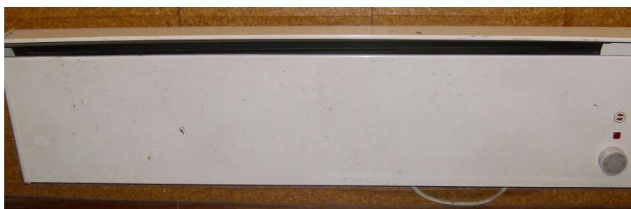
Figura 7.11 - Aquecedor elétrico fixo utilizado no edifício
