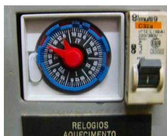
Figura 7.12 - Interruptor horário que regula o sistema de aquecimento
