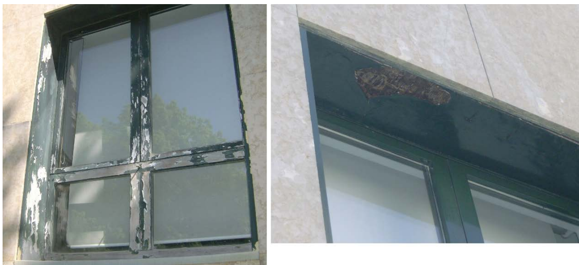
Figura 7.45 - Estado dos vãos envidraçados do edifício
