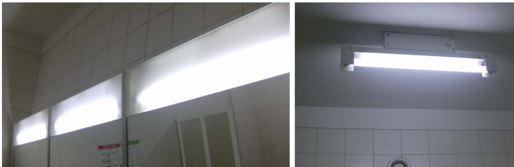
Figura 7.10 - Luminárias utilizadas nas Casas de Banho
