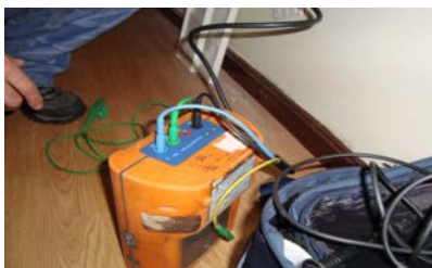
Figura 9 – Medição no quadro eléctrico
