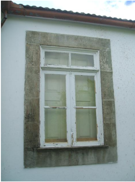
Fig.2.6 – Caixilharia em madeira evidenciando alguma degradação
