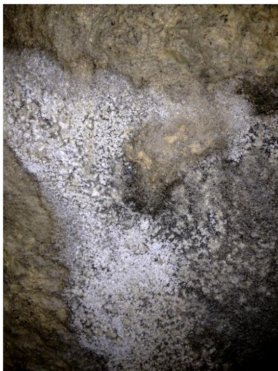
Figura 86 – Manchas de humidade com vestígios de salitre
