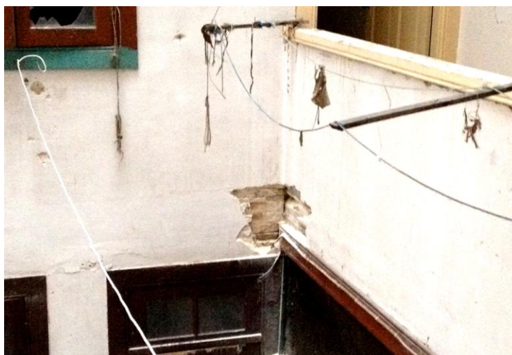
Figura 63 – Parede de tabique do saguão desligada da guarda do passadiço [38]
