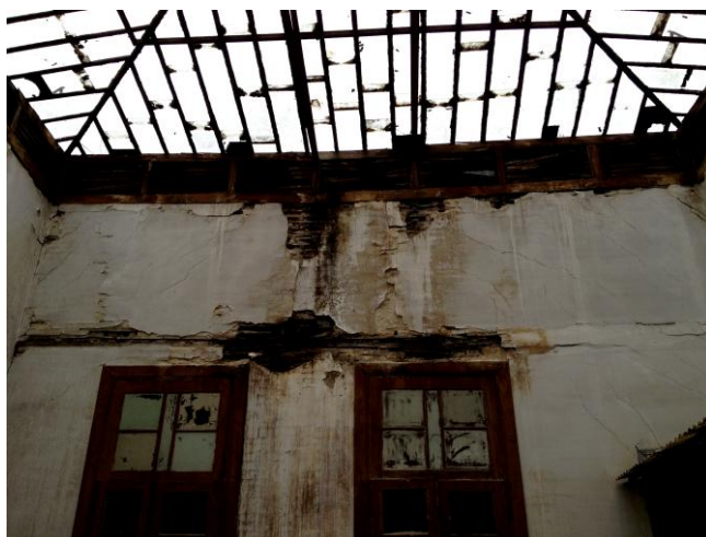
Figura 91 – Degradação no topo da parede de tabique do saguão
