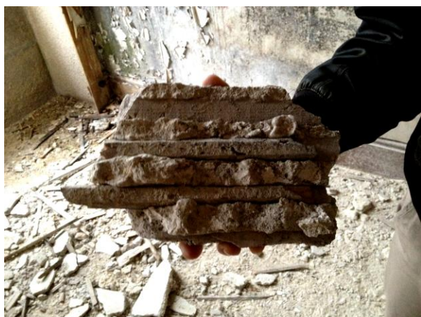
Figura 61 – Parte de reboco e fasquiado de madeira de uma parede de tabique
