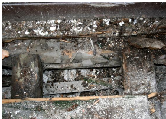
Figura 88 – Degradação superficial do pavimento [38]
