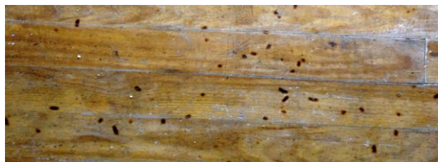
Figura 90 – Queimaduras na madeira
