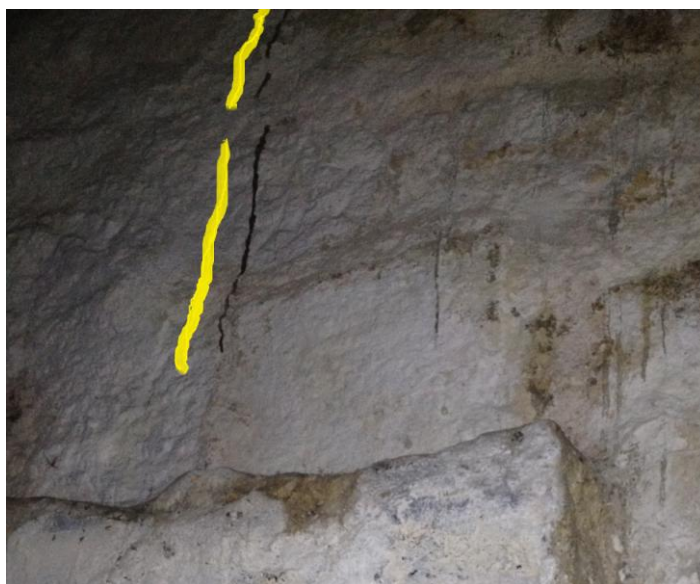
Figura 89 – Caminho de térmitas no piso -1
