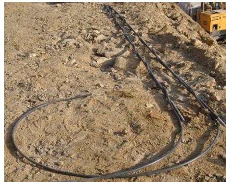
Figura 3.21 - Tubo de Selagem instalado
