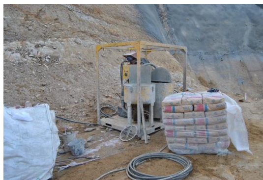
Figura 3.37 - Central de calda de cimento
