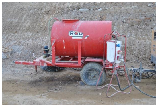
Figura 3.36 - Tanque de água da Central de calda de cimento
