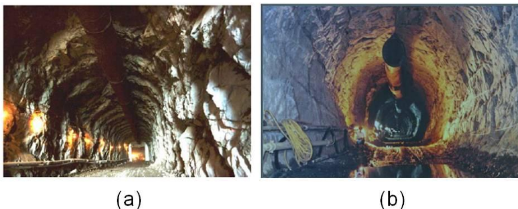
Figura 2.13 – Escavação de galerias: a) com recurso a explosivos; b) com recurso a tuneladora [5].
