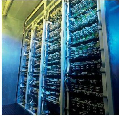
Figura 2.6 - Conjunto de módulos instalados numa subestação de tracção. [14]
