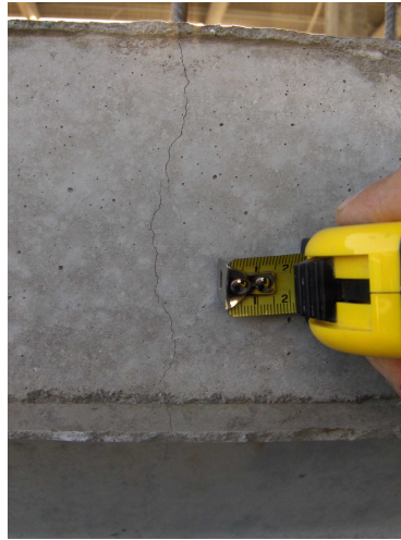
Figura 6.43 Fissura superficial no banzo superior da viga pré-fabricada
