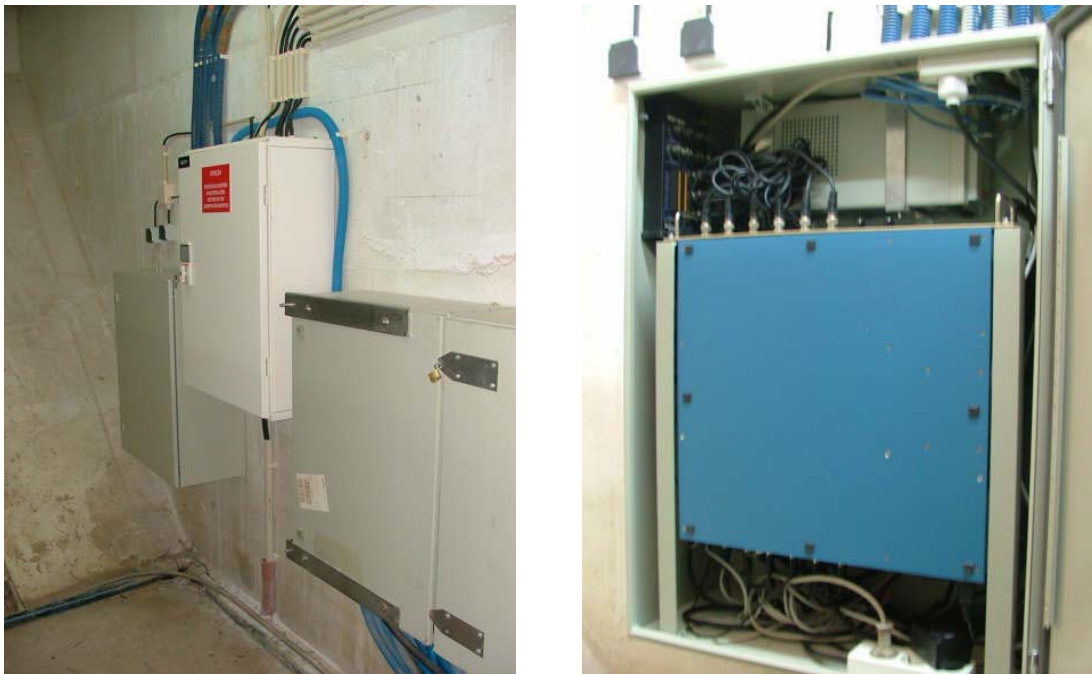
Figura 6.33 – Vista geral do sistema de monitorização (esq.) e do condicionador de sinal, computador e UPS (dir.)
