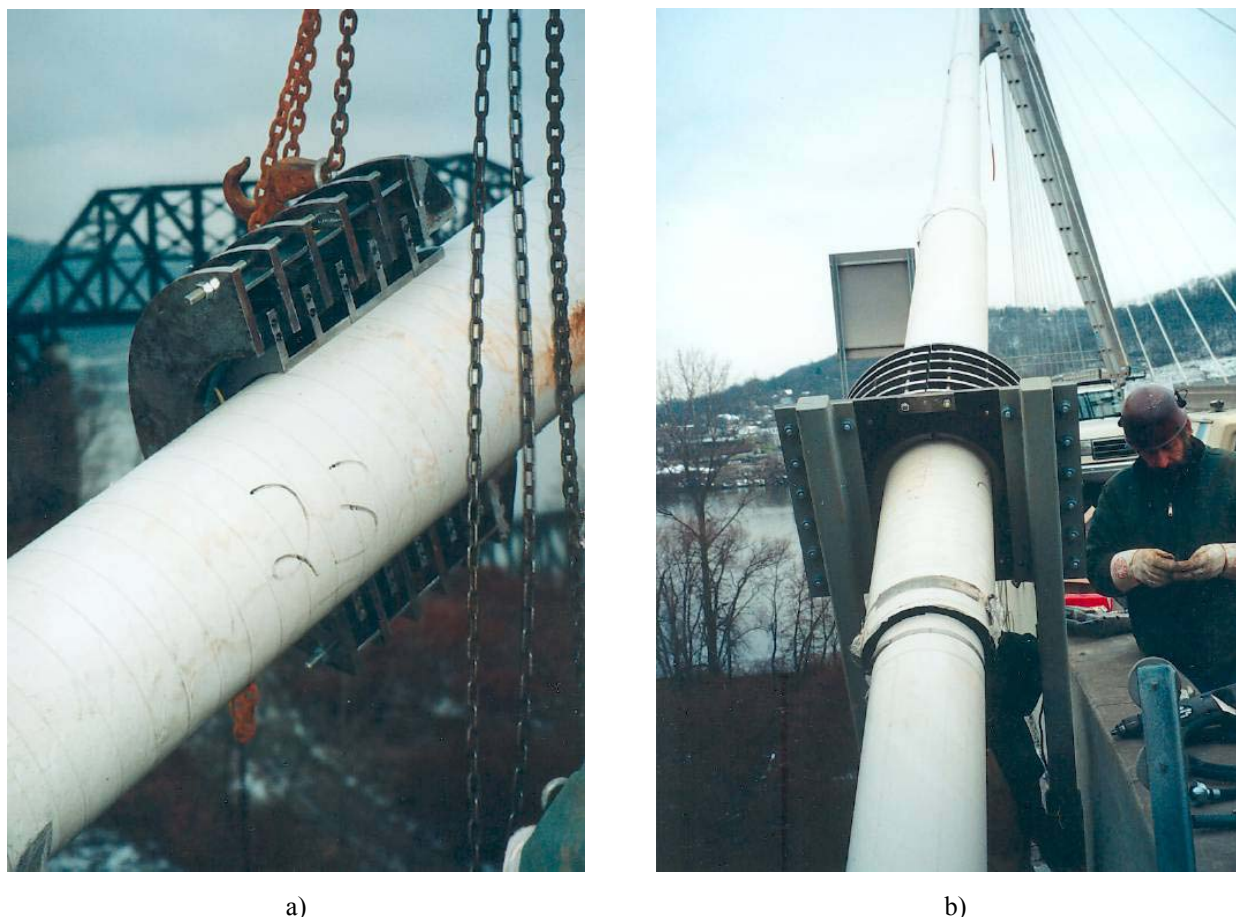
Figura 2.23 – a) Detalhe do amortecedor viscoelástico utilizado na Ponte Veterans Memorial Bridge em Ohio; b) Aspecto do dispositivo ligando os tirantes ao tabuleiro
