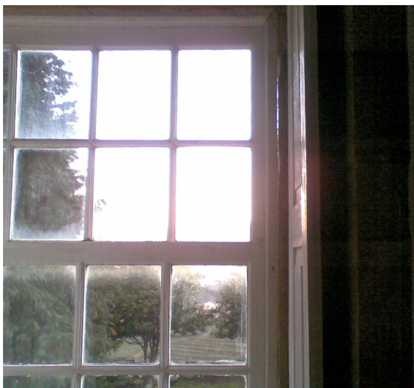
Fig. 5.15 – Folga na ligação entre o aro e o vão
