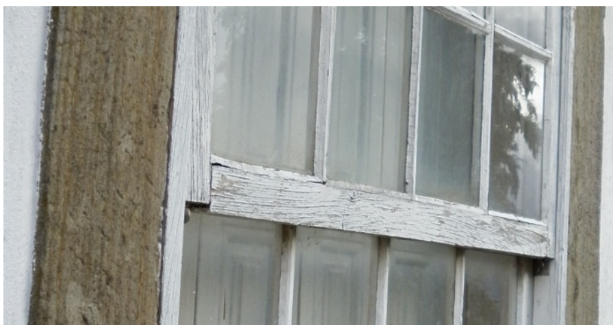
Fig. 5.12 – Janela de guilhotina com anomalias evidentes: decomposição da lenhina e fendas longitudinais
