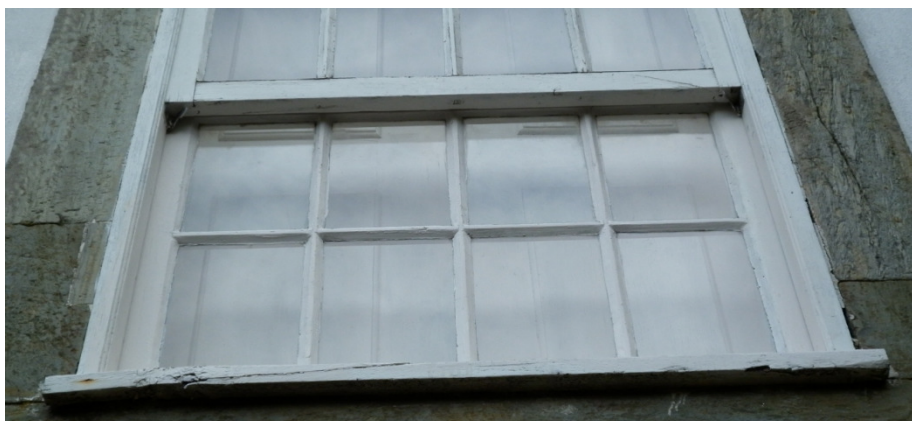
Fig. 5.13 – Janela de guilhotina com elemento em madeira do parapeito partido dando origem à entrada de humidade
