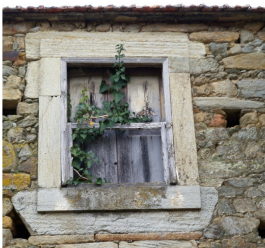
Fig. 4.9 – Parede exterior de edifício em ruína
