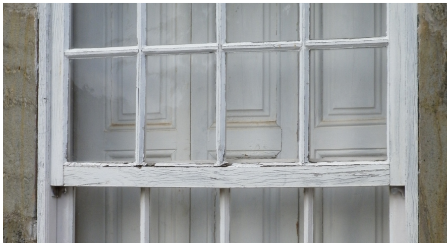
Fig. 5.14 – Janela em guilhotina com deterioração pronunciada ao nível das massas e betumes de suporte dos vidros e ao nível da madeira
