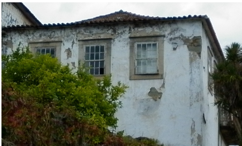
Fig. 4.25 – Revestimento exterior degradado
