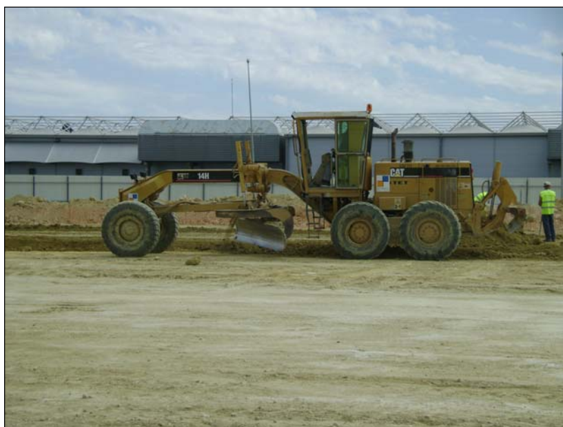
Figura 5.2 – Regularização da camada de fundação do aterro experimental (foto cedida por Santos, 2009)
