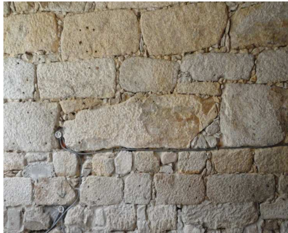
b) Parede 2 (1º piso)_Zona 1 – CG2
