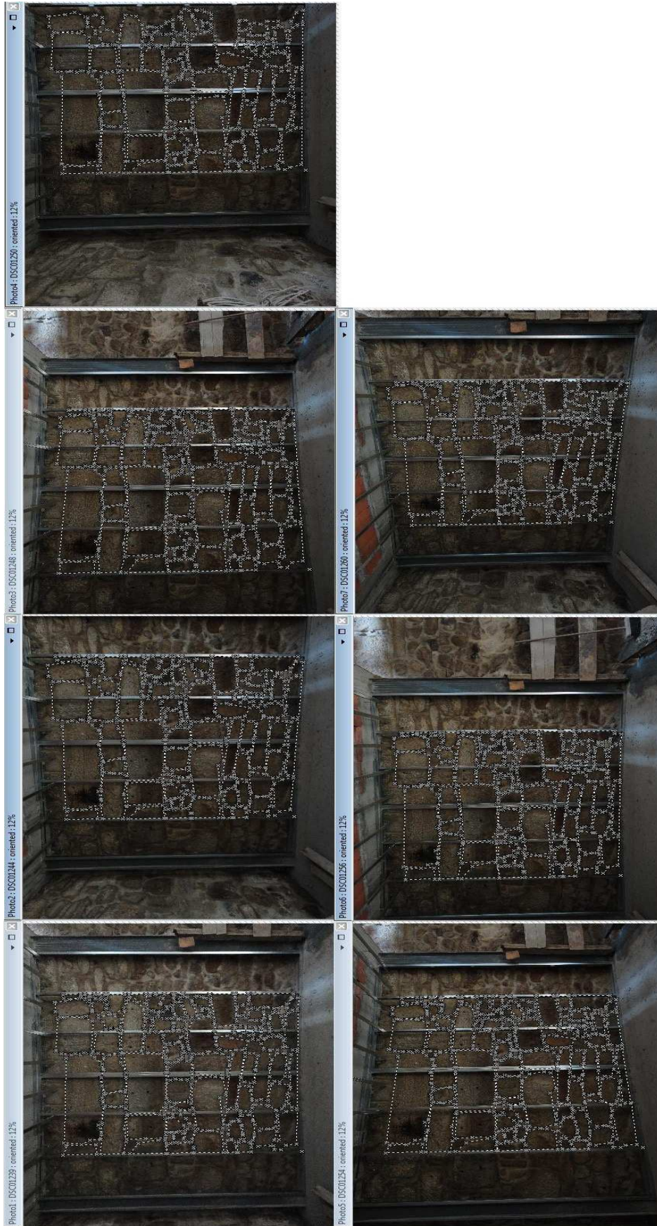
Levantamento Geométrico da Parede 1 (1º piso) da Casa do Quarteirão da Feitoria Inglesa_FI1
