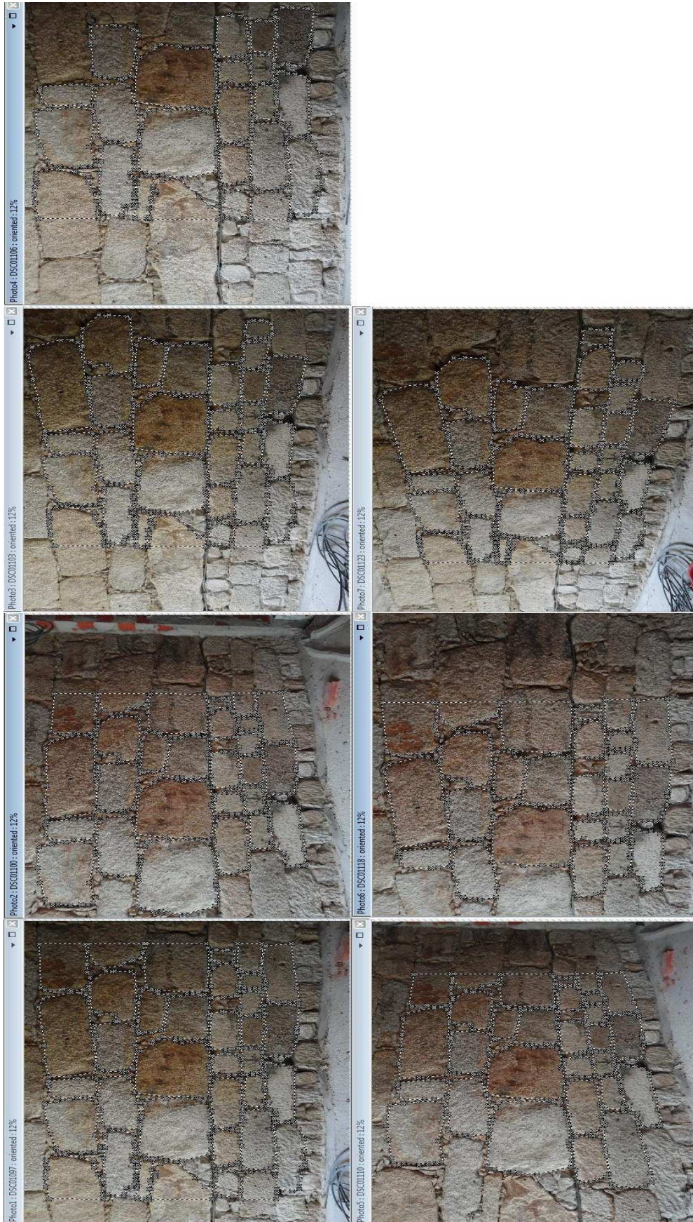
Levantamento Geométrico da Parede 2 (1º piso)_zona 2 da Casa do Quarteirão do Corpo da Guarda_CG3
