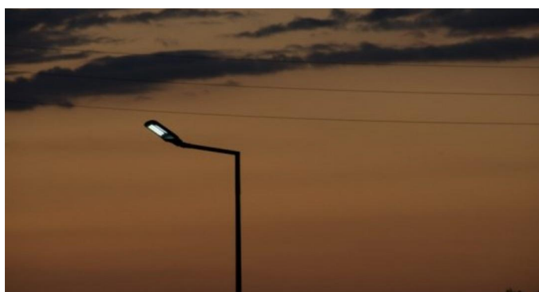
Figura 4.38 - Pormenor da luminária referente à solução de iluminação utilizada na A29, nó de Angeja, km 1 [45]
