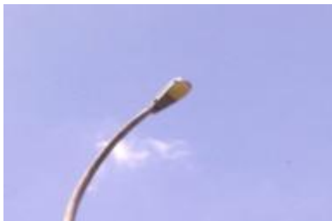
Figura 5.1 - Luminária actualmente existente
