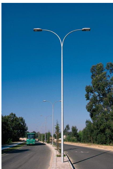
Figura 4.16 - Luminárias instaladas na zona do Tejo [20]
