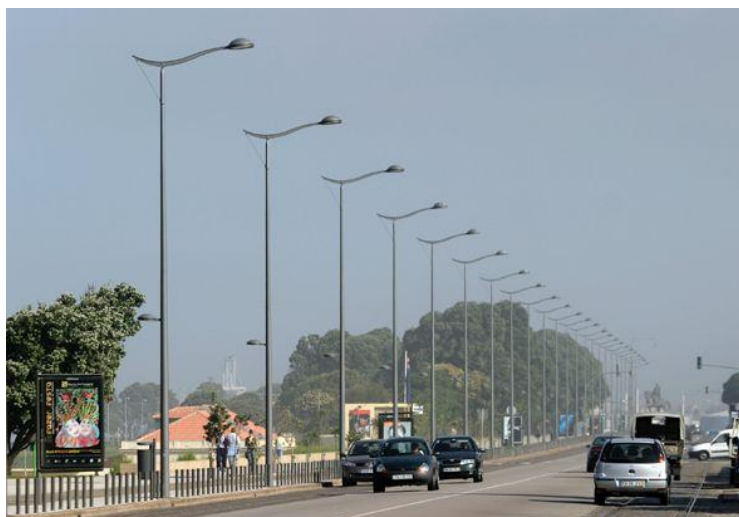
Figura 4.21 - Luminárias instaladas em Montevideo, Porto [20]
