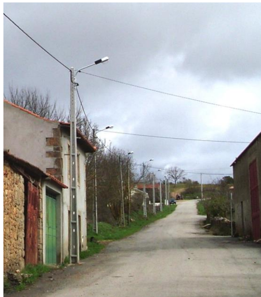
Figura 4.27 - Luminárias instaladas em Mogadouro [40]
