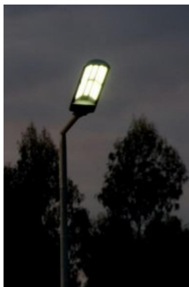
Figura 4.39 - Pormenor da luminária referente à solução de iluminação utilizada na A29, nó de Angeja, km 1 [45]
