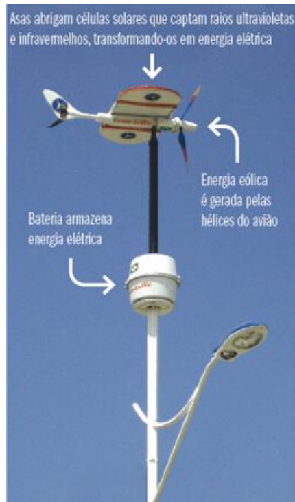
Figura 4.48 - Pormenor da instalação híbrida para alimentação de iluminação pública (Brasil) [52]
