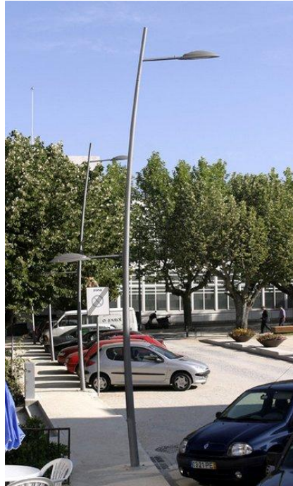
Figura 4.22 - Luminárias instaladas em Seia [20]
