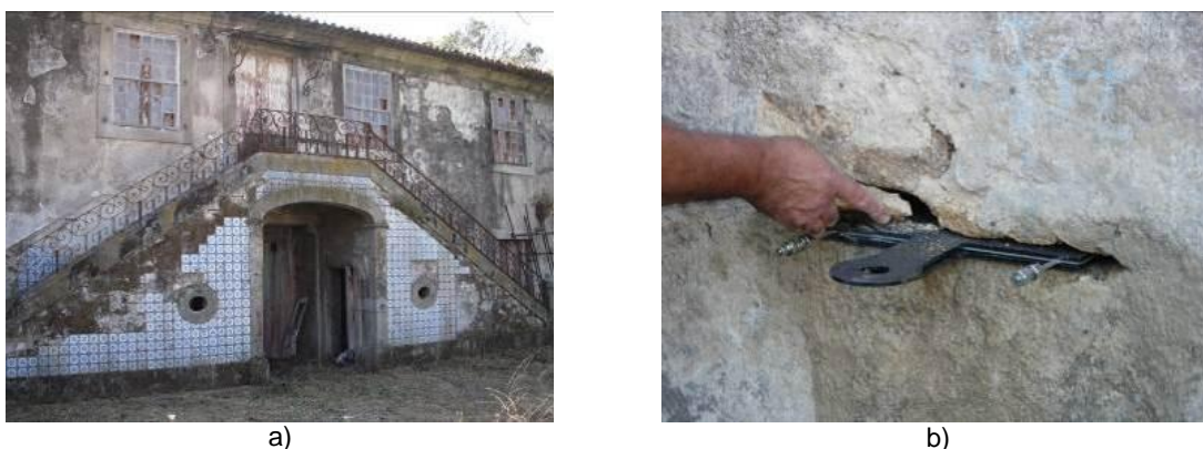
Figura 6.30 – Primeira avaliação da modificação introduzida no ensaio com macacos planos: a) edifício objecto de teste; b) sistema de chapas colocado.
