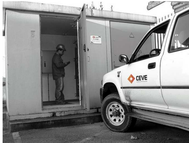
Figura 2.3 - Posto de transformação da CEVE [2]
