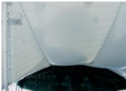
Fig. 3.25 – “Ponding” numa cobertura em tela – Pensylvania, EUA
