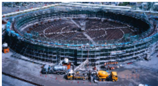
Figura 2.3.: Tanque destinado ao armazenamento de gás natural liquefeito (Japão)
