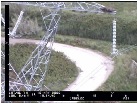
Fig. 4.2.1.2 – Fase afectada pelo curto-circuito
