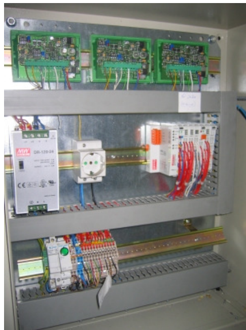
Figura 4. 11 Quadro eléctrico da bancada de ensaios
