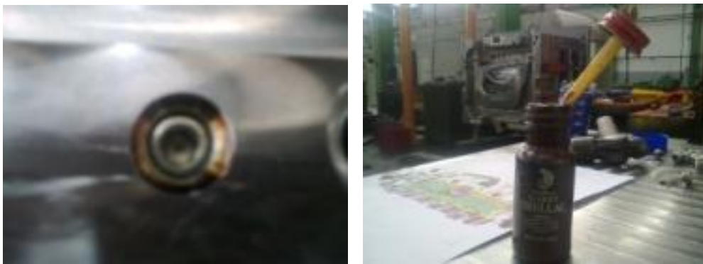
Figura 32 – Aplicação de bujões no circuito de águas
