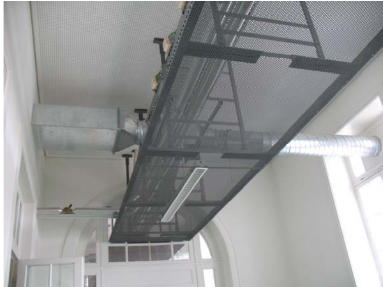
Figura 3.5 – Sistema de ventilação numa sala da Escola Secundária Rodrigues de Freitas [fotografia da autora]
