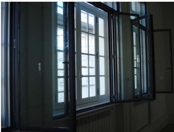
Figura 7.12 – Caixilharia interior na sala 31 da Escola Secundária Rodrigues de Freitas [75]
