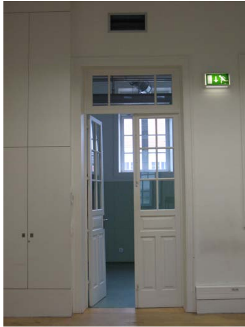
Figura 7.11 – Localização da grelha de admissão de ar na sala 0.07 na Escola Secundária Rodrigues de Freitas [fotografia da autora]
