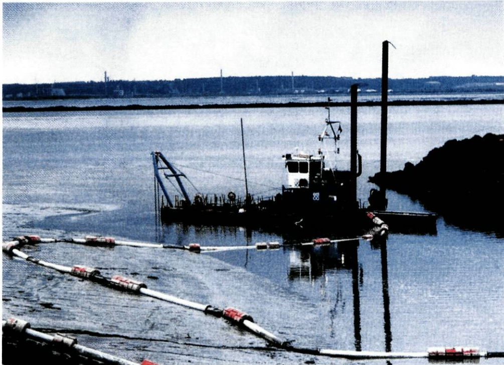
Figura 1.3.3 – Draga de sucção estacionária com conduta de rejeição ligada à margem (Bassoullet e Guillaud, 1999).
