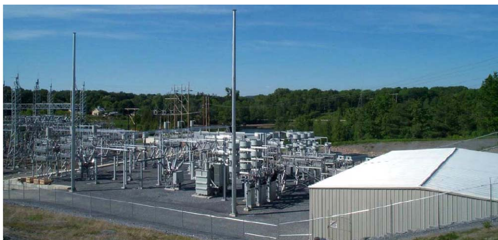
Figura 3.56- Panorama geral da subestação VELCO Essex e respectivo STATCOM.
