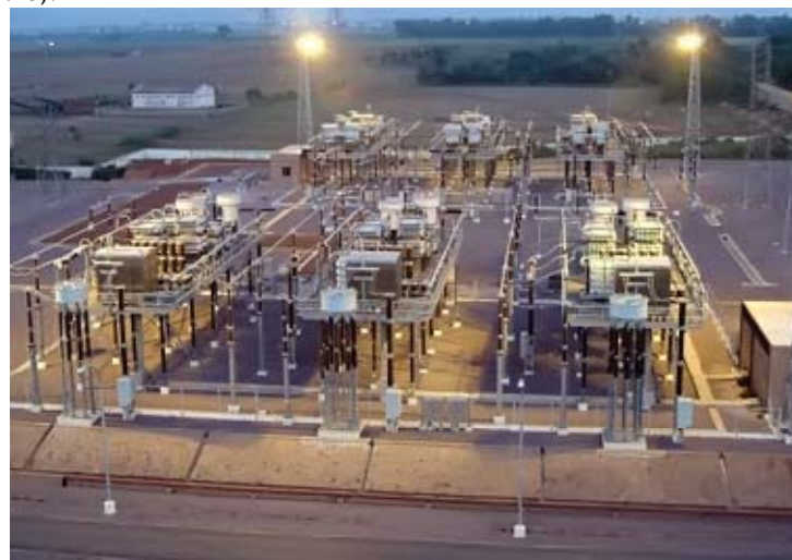
Figura 3.54 - Panorama geral da subestação do TCSC [56].
