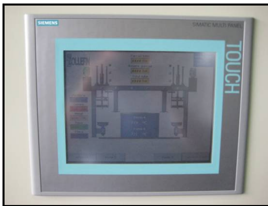
Figura 3.22 – PLC de controlo e de aquisição de dados do vazamento.
