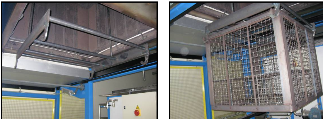
Figura 3.47 – “Aranha” para fixação e elevação do cesto com a carga a tratar.
