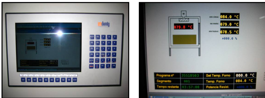
Figura 3.50 – Controlador de temperatura do forno de envelhecimento.
