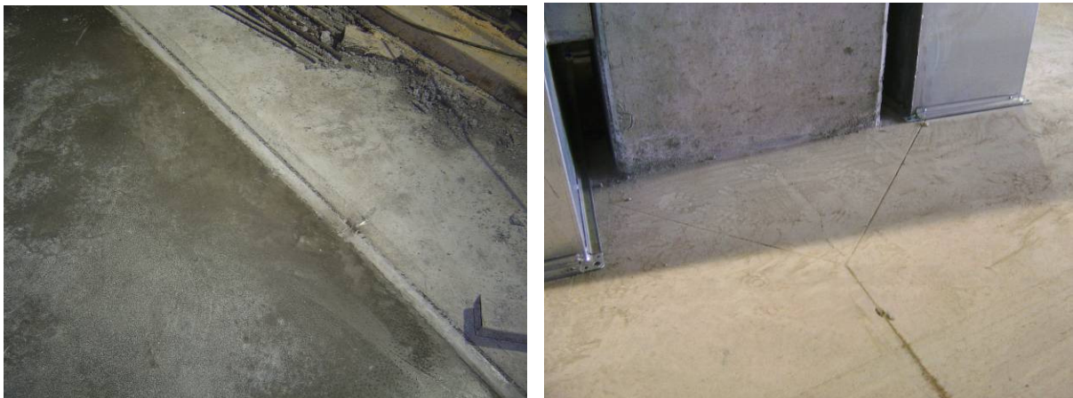
Fig.5.31 – Esquerda: Aspecto final das juntas de betonagem; Direita: Aspecto final das juntas serradas.
