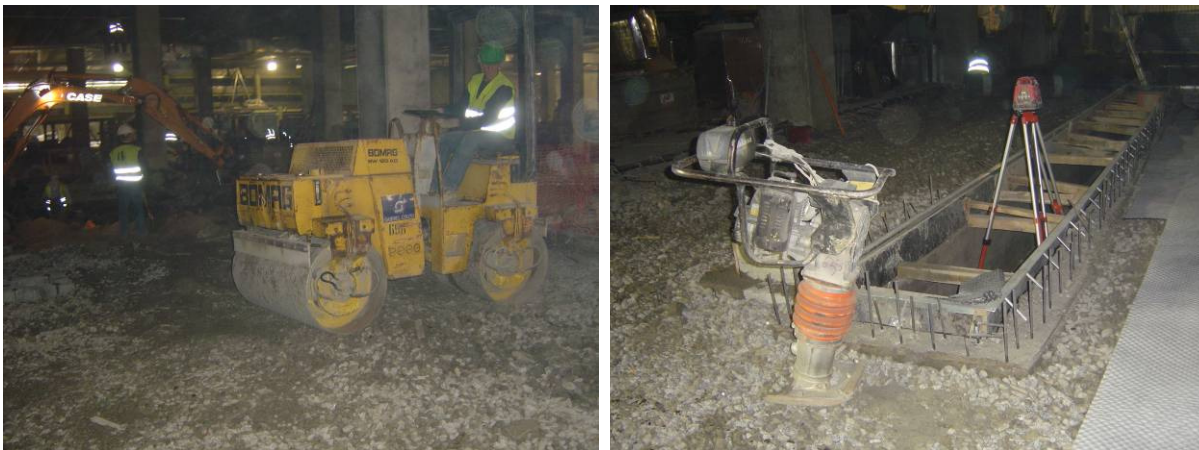
Fig.5.17 – Esquerda: Material britado regularizado por um compactador de rolo, Direita: Compactador tipo «sapo».
