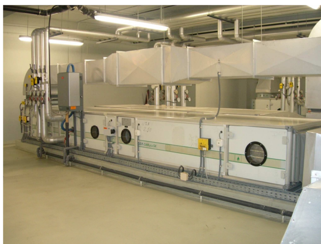
Figura 16 - Unidade de tratamento de ar de uma sala de operações no Porto (HPP)
