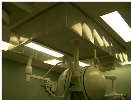
Figura 7 - Tecto de fluxo laminar (Hospital Privado da Boavista)
