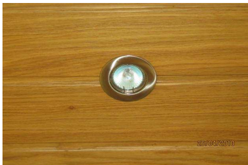
Fig.3.38 – Focos de iluminação
