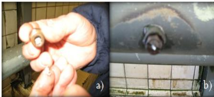
Figura 32 - Bicos Obstruídos: a) vista do interior; b) vista do exterior.
