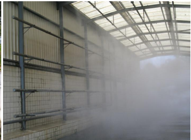
Figura 31 - Túnel de água em funcionamento.
