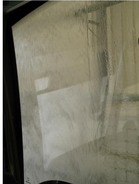
Figura 39 - Queda de água ao longo janela.
